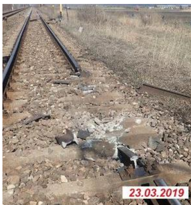
figura 1.32 Șină de tip R65 ruptă, care a condus la deraierea vagonului, (AGIFER, 2020d)
