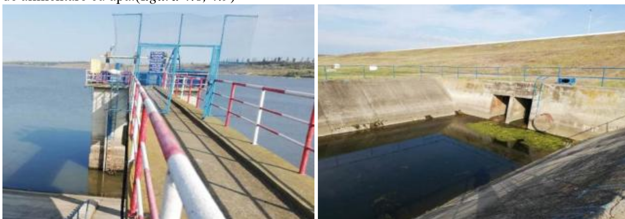
Figura 4.8. – Vedere turn de manevră și deșușarea golirii de fund
