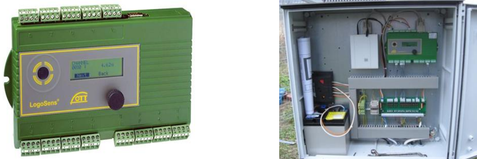
Figura 4.2 Datalogger de tip OTT - Logosens 2 pentru colectarea de date la distanță și monitorizare pe termen lung a parametrilor măsurăți
