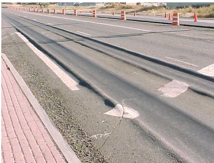
Fig. 1.3. Fotografie care demonstrează efectul distructiv al traficului greu asupra drumului (Lees, 2024)
