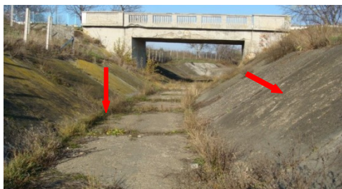
Fig. 8.21. Vedere generală a stării de degradare a pereului de dale pe prima parte a canalului CD2 în 2009 [Luca M. ș.a., 2009].
