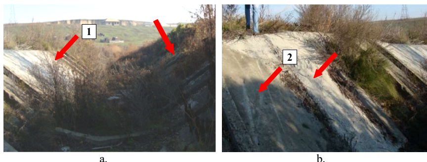
Fig. 8.29. Fenomene de degradare a secțiunii de curgere pe tronsonul CR2 în anul 2009: a – vedere generală a CR2 în zona de subtraversare a conductelor, 1 – suprafață de taluz reconstituită fără macrorugozitate; b – detaliu privind modul de refacere a secțiunii de curgere a canalului, 2 – macrorugozitate pe taluz nerefăcută [Luca M. ș.a., 2009].
