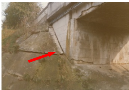
Fig. 8.15. Vedere culee stângă cu deplasarea conului superior [Hobjilă V. ș.a., 1998]
