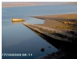
Fig. 8.45 Fenomenul de eroziune în zona de debușare a conductelor de aducțiune [Luca M. ș.a., 2009].
