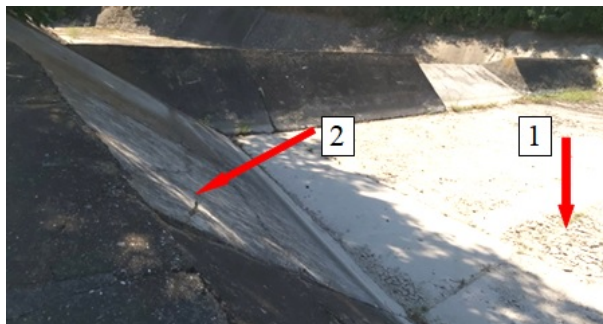
Fig. 8.6. Gradul de degradare a structurii canalului de acces în anul 2020: 1 – degradarea structurii de beton a dalelor de pe radier, 2 – fisuri și crăpături în dalele de pe taluz la contactul cu paramentul barajului [ABA Prut Bârlad, 2020].
