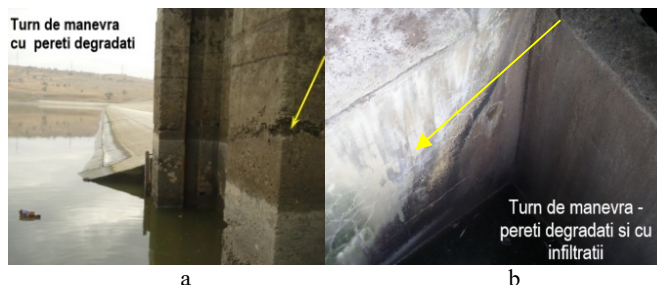
Fig.2.3.Fenomene de degradare a turnului de manevră: a – Baraj Mânjești, râu Crasna jud. Vaslui; b – Baraj Aroneanu de pe râul Ciric, jud. Iași [ABA Prut Bârlad, 2022].
