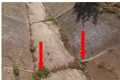
Fig. 8.23. Detaliu privind gradul de eroziune a dalelor și completarea rosturilor de pe taluz cu mortar pe tronsonul CD2 [ABA Prut-Bârlad, 2020].
