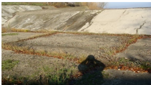
Fig. 8.11. Starea avansată de degradare a pereului din dale mari de beton pe CD1 în aval de deversor în 2009 [Luca M. ș.a., 2009].
