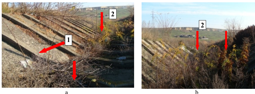
Fig. 8.25. Starea de degradare a secțiunii de curgere în zona centrală pe tronsonul CR1, an 2009: a – vedere generală a tronsonului din secțiunea de racord cu CD2, 1 – eroziunea avansată a betonului pe taluz, fragmentarea pereului la coronament; b – blocarea secțiunii de curgere cu arbuști, 2 – arbuști pe lungimea și lățimea canalului [Luca M. ș.a., 2009].
