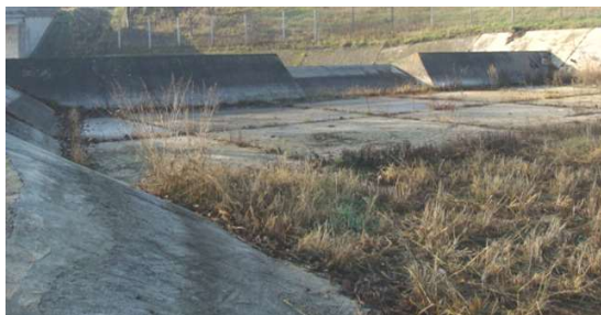
Fig. 8.4. Vedere generală a Canalului de Acces dinspre lac, cu evidențierea procesului de colmatare în zona de intrare și dezvoltarea vegetației în rosturile pereului din dale de beton în anul 2009 [Luca M. ș.a., 2009].
