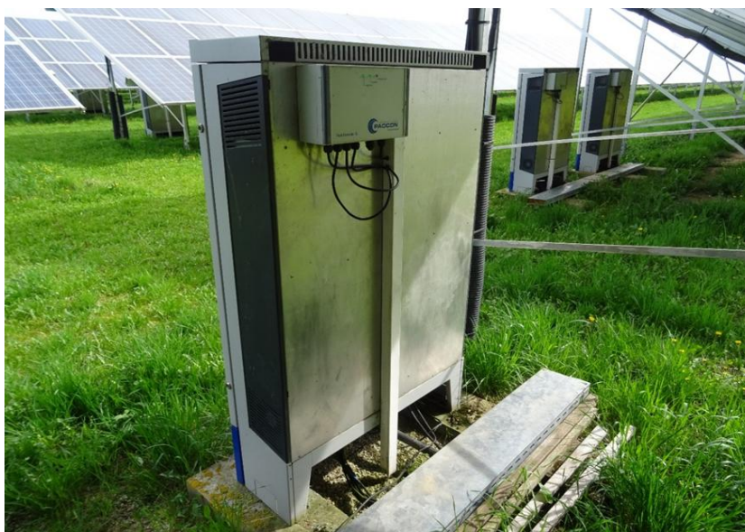
Fig 0.1 Invertor, vedere din spate cu PADCON PID-Box (Float Controller SI).
