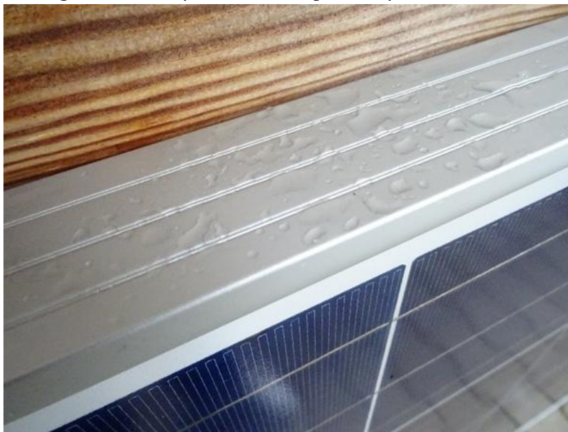
Fig 0.16 Modul fotovoltaic umezit
