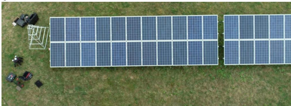
Figure 0.4 Configurația de inspecție pe un sistem de aprox. 3 MWp, pe două rânduri de module
